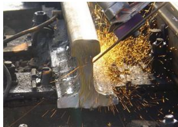
Авария на ж/д в Могилевской обл. 10.05.2011
