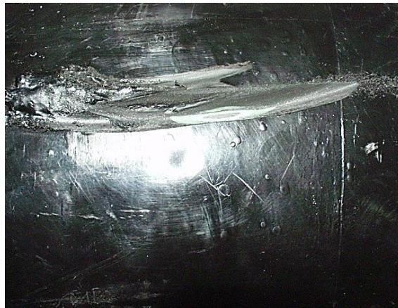
несквозное повреждение покрытия- сдиры
