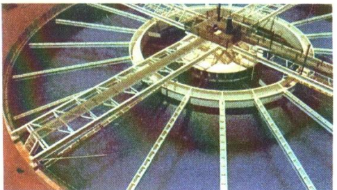
Этапы очистки воды и выделения иловых осадков (сырьё для биогазовых установок)
