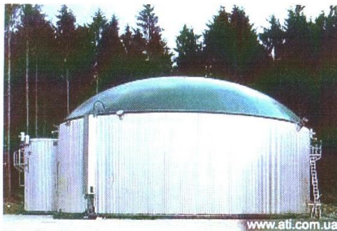
Реактор биогазовой установки
