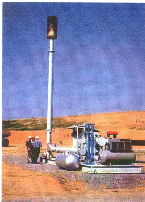
Силовая установка на биогазе
