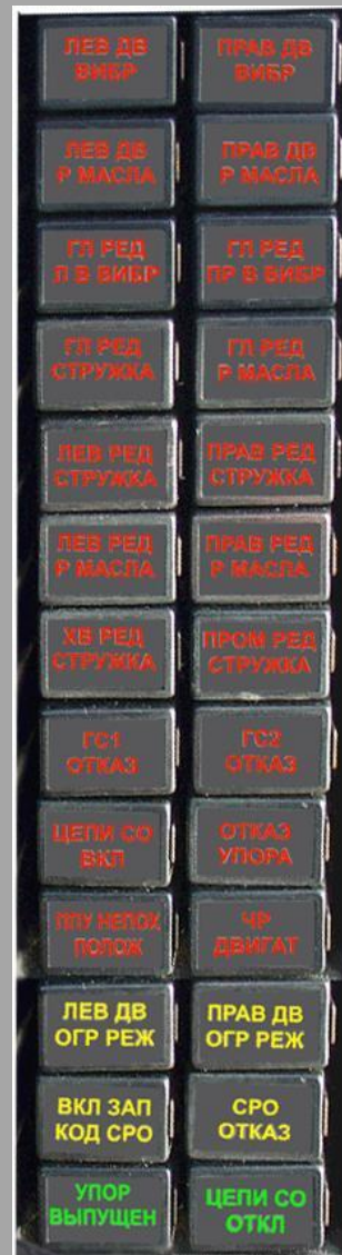
Табло системы аварийной сигнализации
