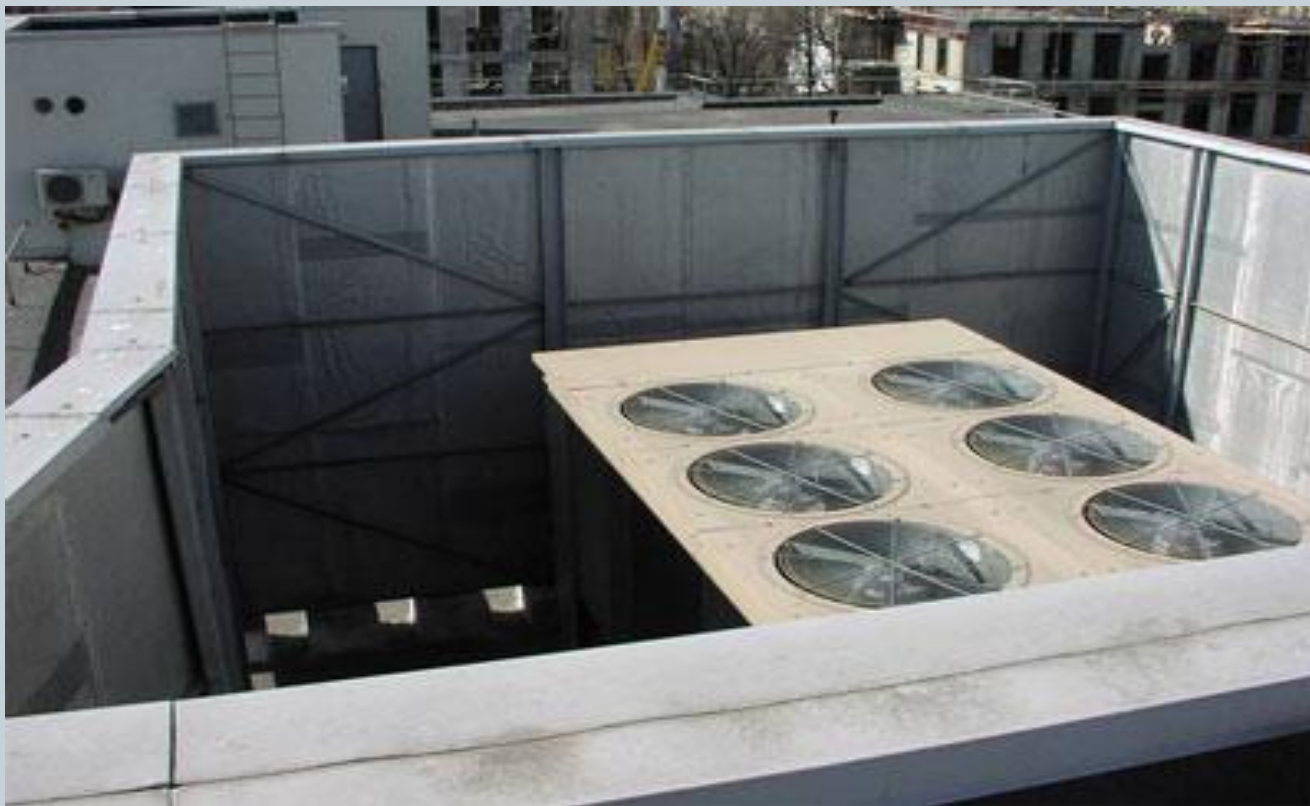
Шумопоглощающий экран около холодильной машины
