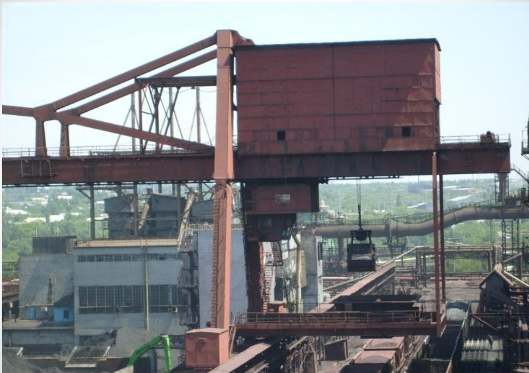
Плоская опора вантового моста
