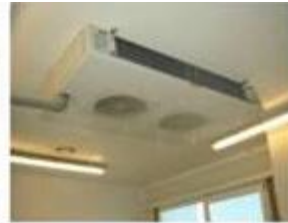
4. Вентиляция и кондиционирование
