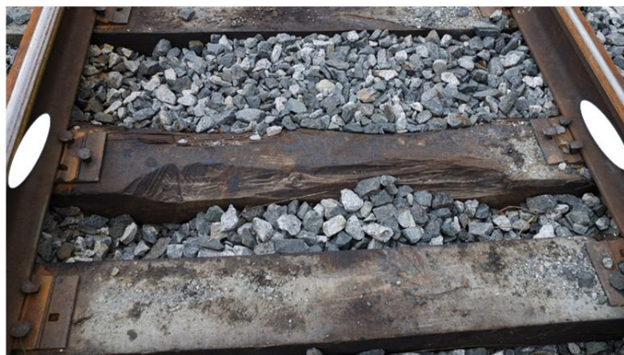
Замена в первоочередном порядке
