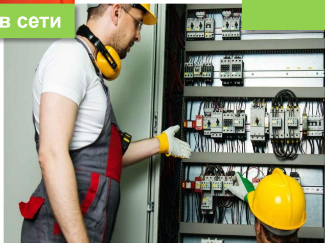
Проверка исправности предохранителей и автоматики
