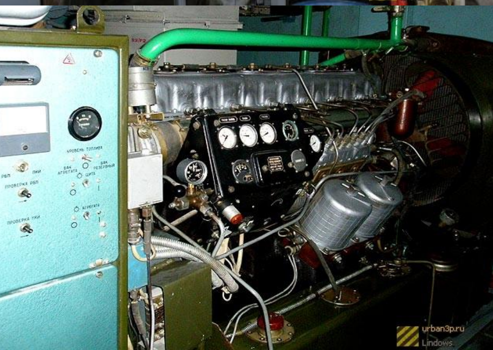
Дизельная электростанция (ДЭС).
