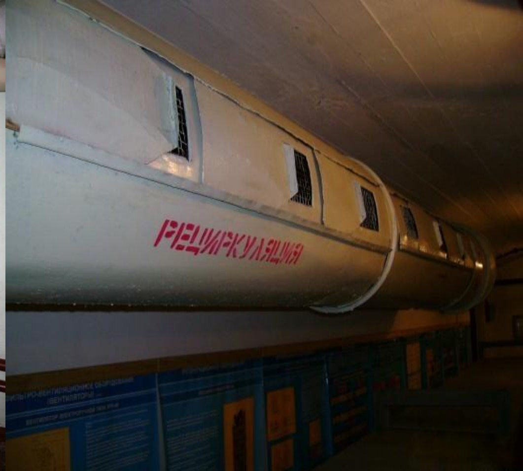
Выпускные отверстия на воздуховодах
