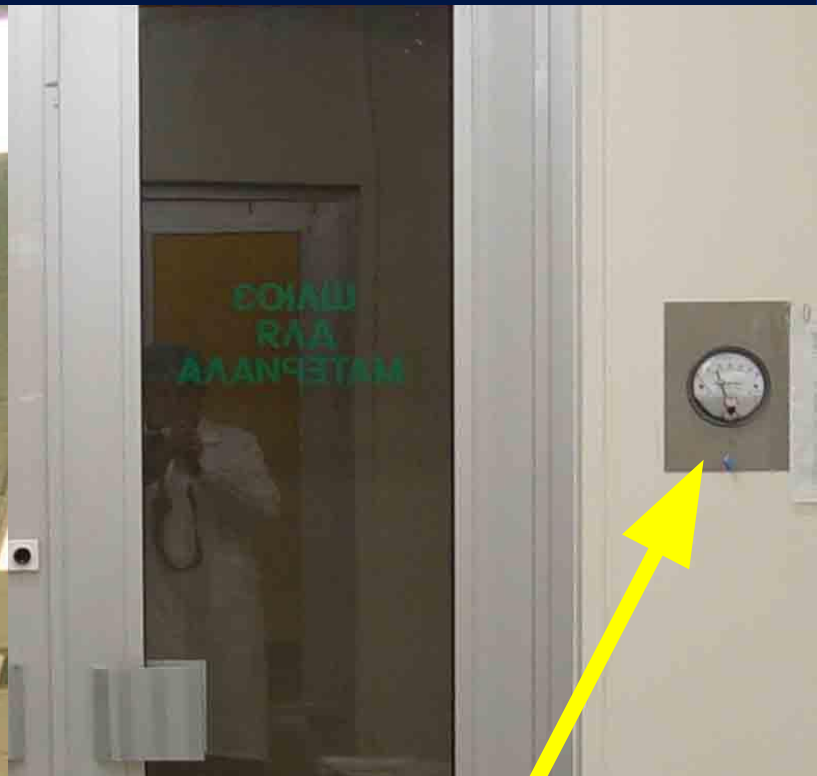
Датчик разницы давления воздуха между помещениями
