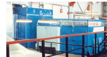
ГТУ-12П на КС «Ординская» ООО «Газпром трансгаз Чайковский»
