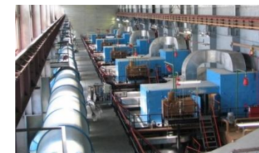
ГТУ-16П в составе ГПА-16РП «Урал» на КС-18 Ординская, ООО «Газпром трансгаз Чайковский»
