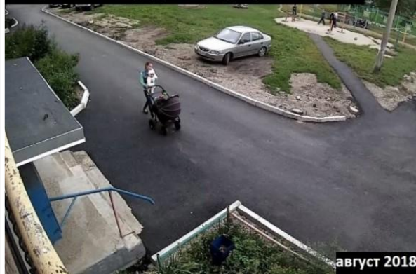
асфальтирование дворовой территории МКД №76 по ул. Одесская (реализация программы «Современная городская среда»)
