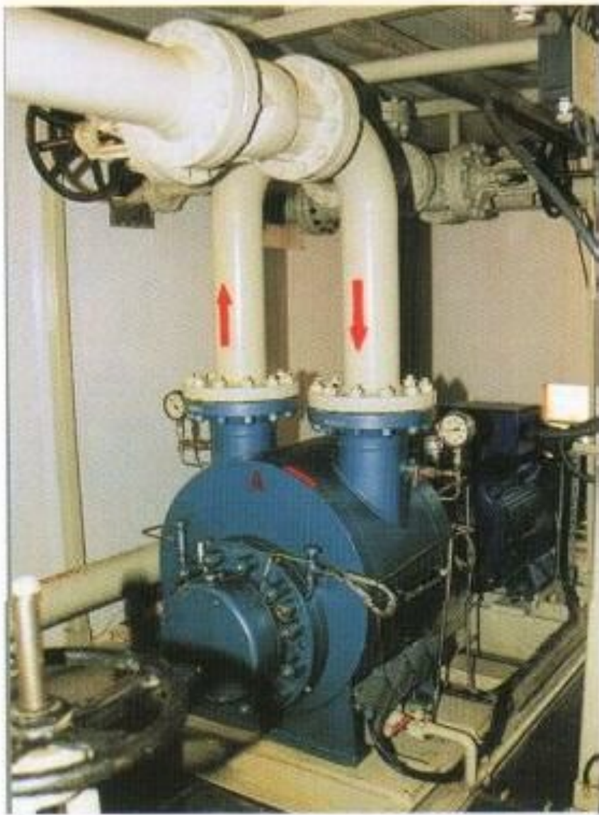
Мультифазный насос по перекачке нефти
