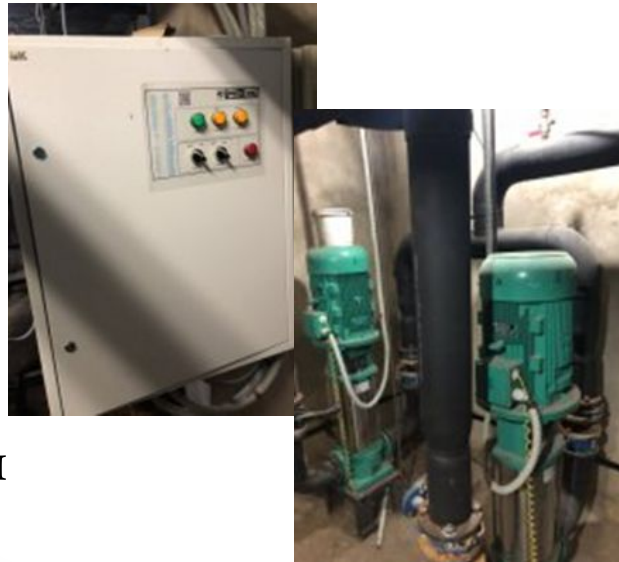
Шкаф управления противопожарными насосами
