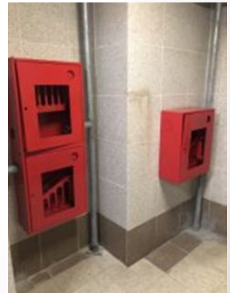
Пожарный шкаф без стволов, рукавов и кнопок пуска ВПВ
