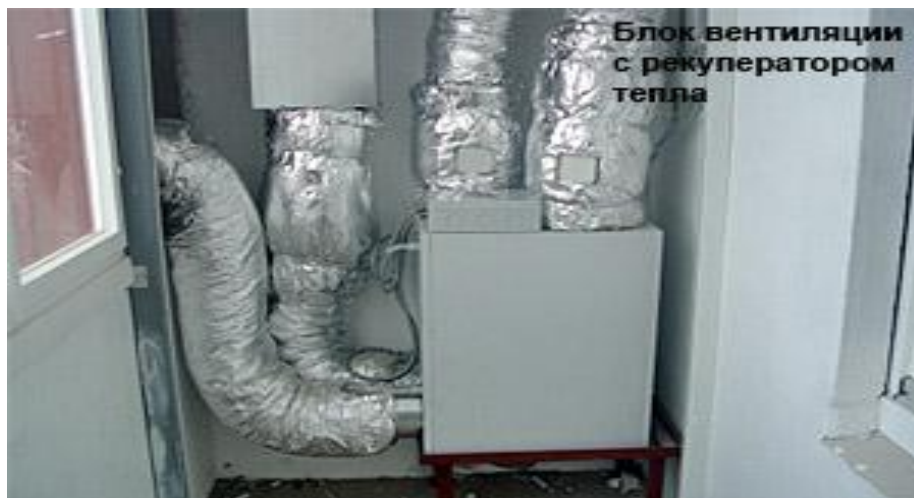
Рекуператоры в лоджии
