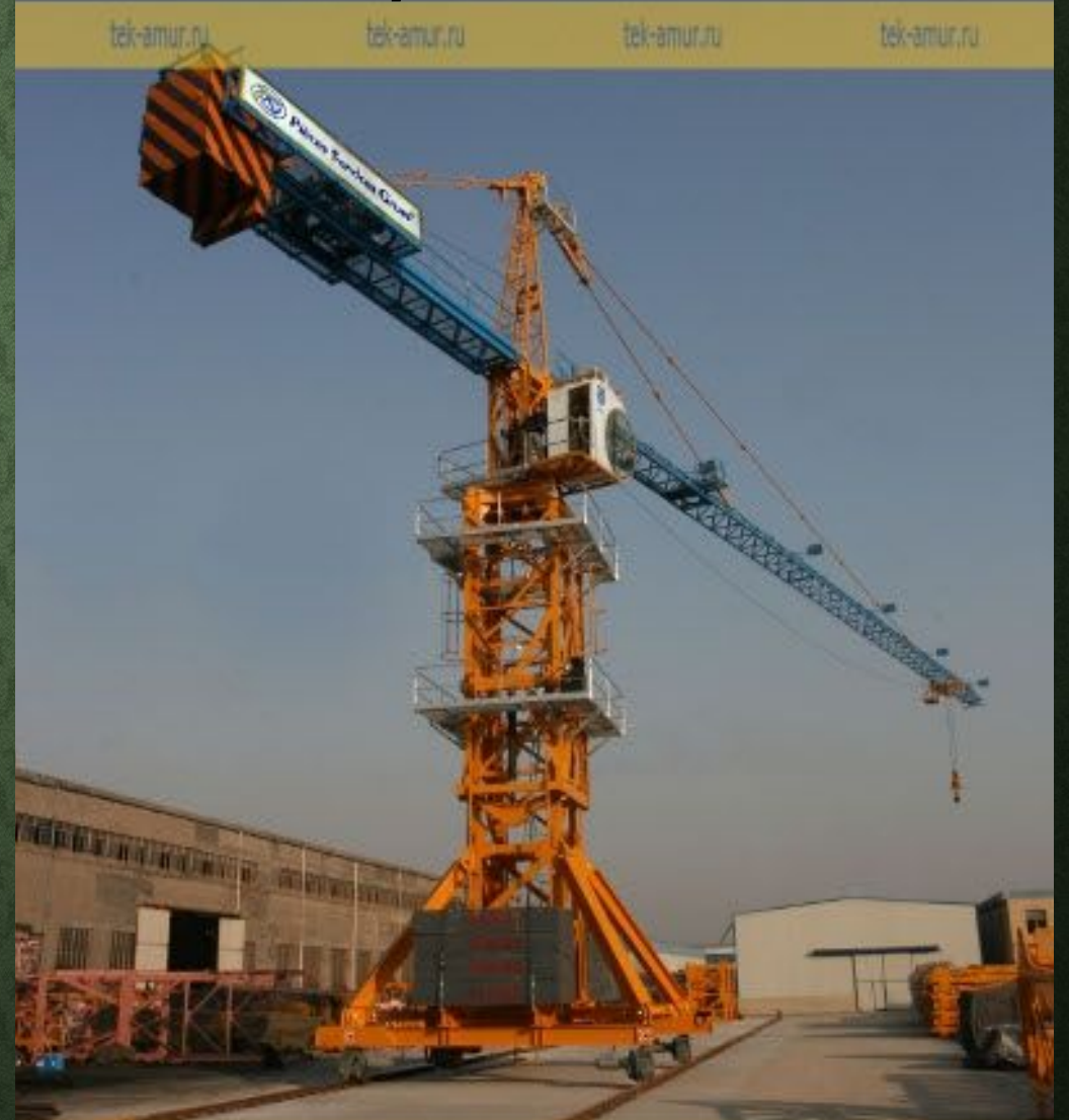
Башенный кран QTZ80 на рельсовом ходу
