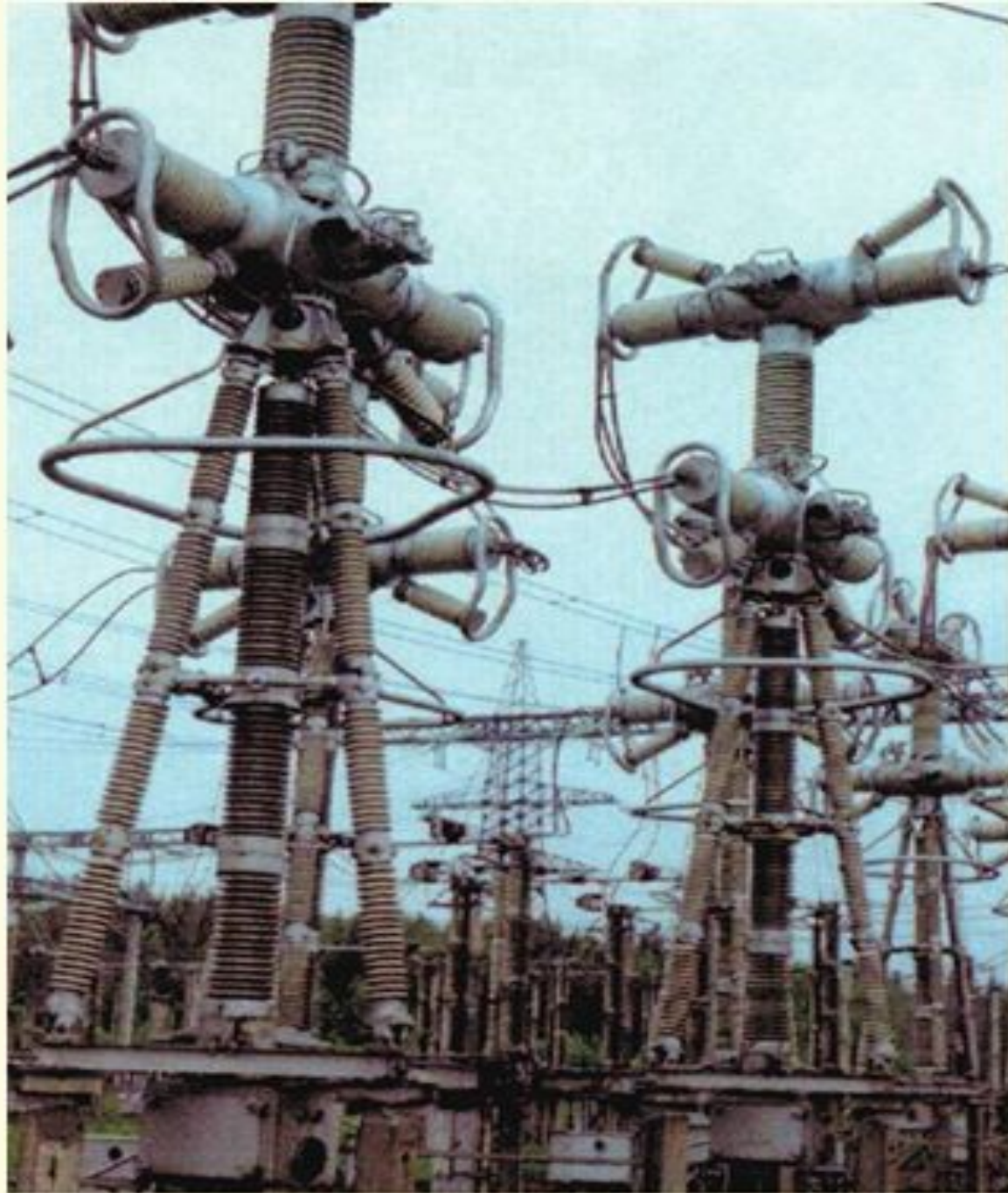
. Высоковольтные выключатели на напряжение 330 кВ
