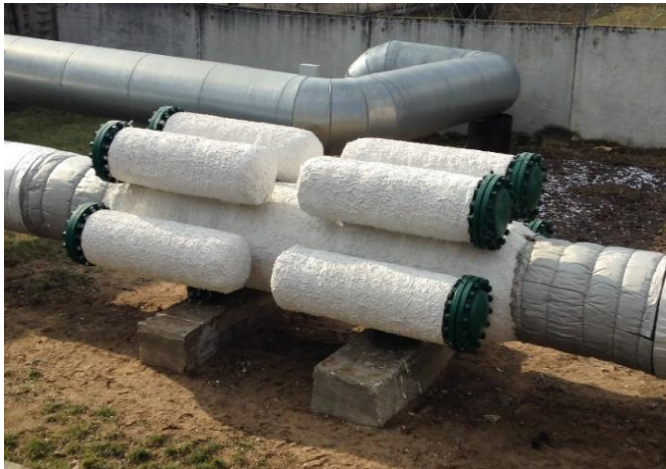
Стабилизатор давления «ЭКОВЭЙВ» СДТ 25-600-8-2, установленный на напорном трубопроводе ТМ-29
