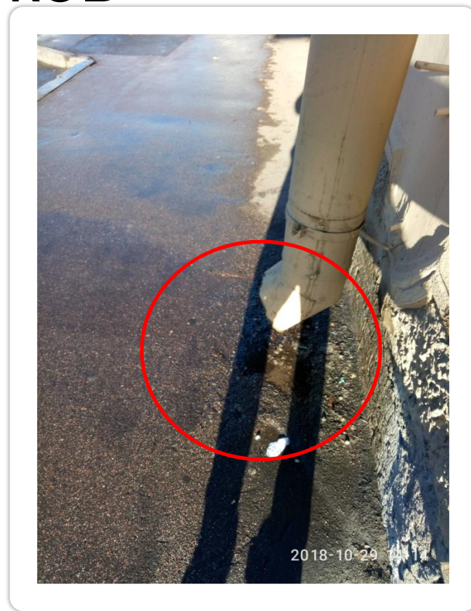
Пример неорганизованного водостока г. Санкт-Петербурга Лиговский пр. (напротив ст. метро «Обводный канал»)
