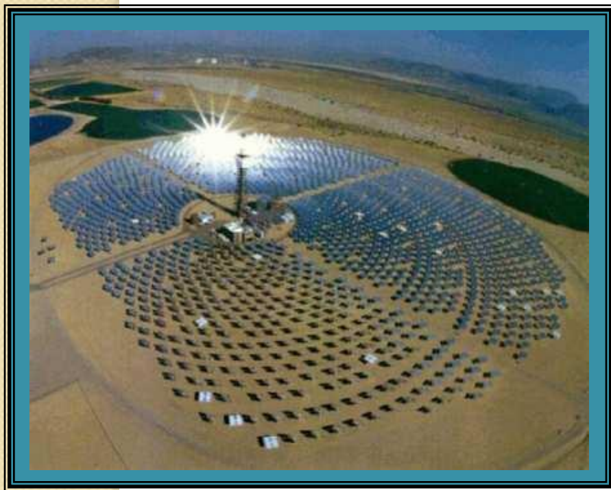
Солнечная электростанция (СЭС)
