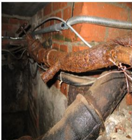
Труба системы водоснабжения сильно повреждена коррозией.
