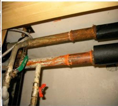
В следствии некачественно выполненных работ стояки системы водоснабжения протекают.
