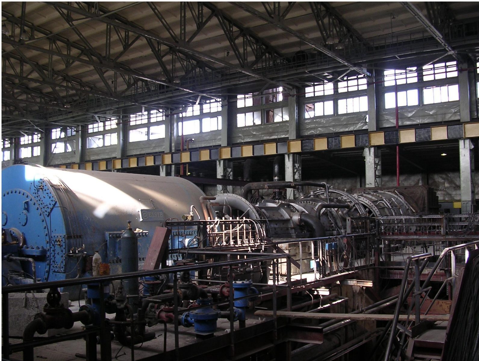
Рис. 1. Общий вид турбогенератора
