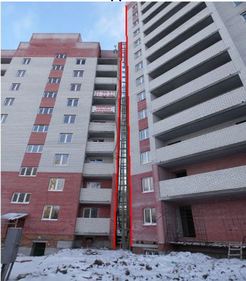
Рис. 6 - Зазор между 14 - и 9- этажной секцией
