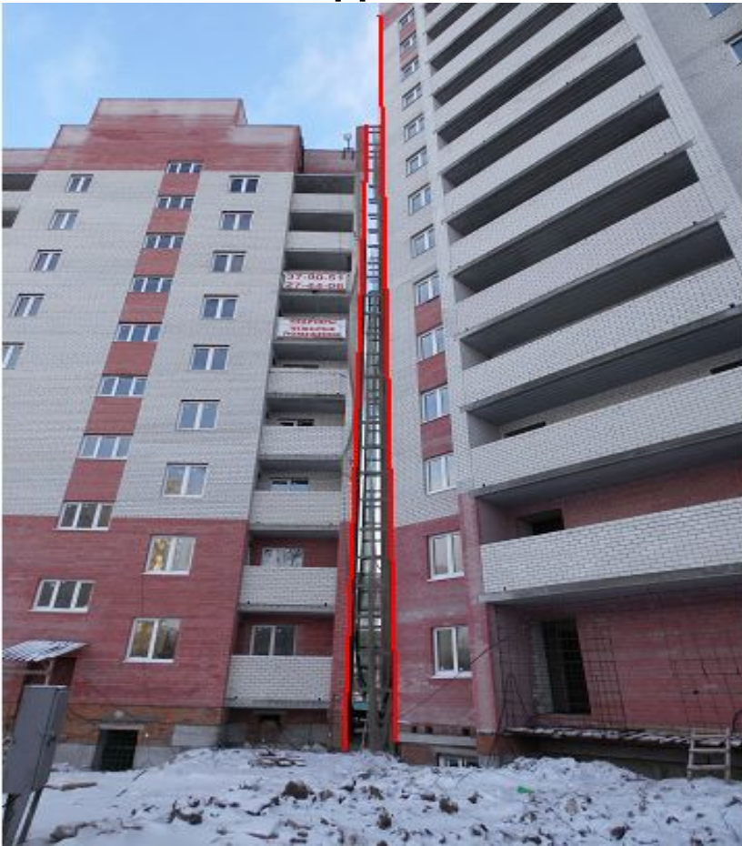
Рис. 6 - Зазор между 14 - и 9- этажной секцией
