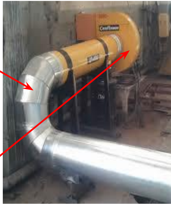
4. воздуховод соединяющий шахту ДУ и вентилятор
