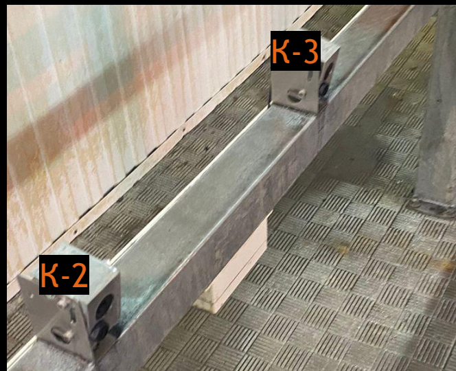
Датчики К-2 и К-3 - определяют зону парковки, установлены под шаттлом
