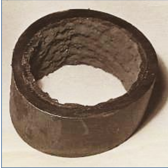
Шлаки на трубопроводе
