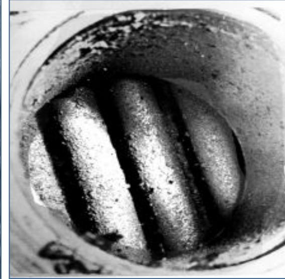
Отложения шлаков в теплообменнике
