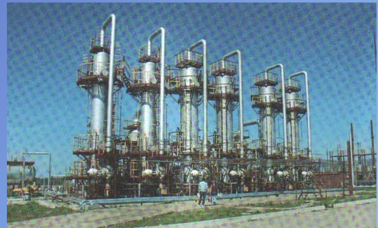
Установка для очистки и осушки газа
