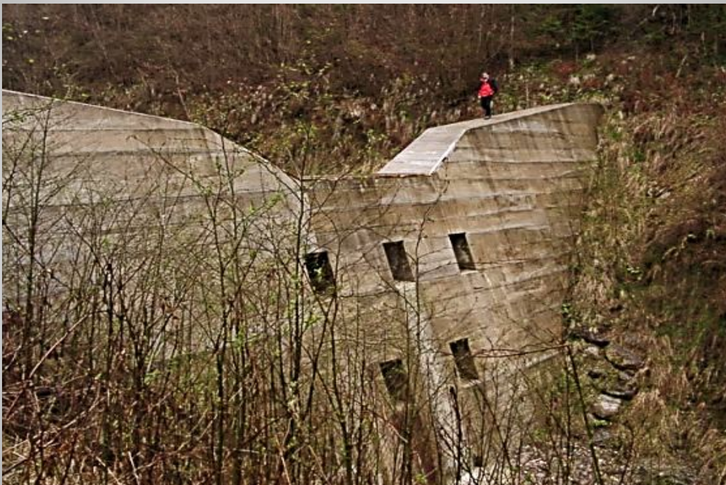
Селезадерживающая плотина с пятью пропускными отверстиями (Трюбенбах, Каринтия, Австрия)
