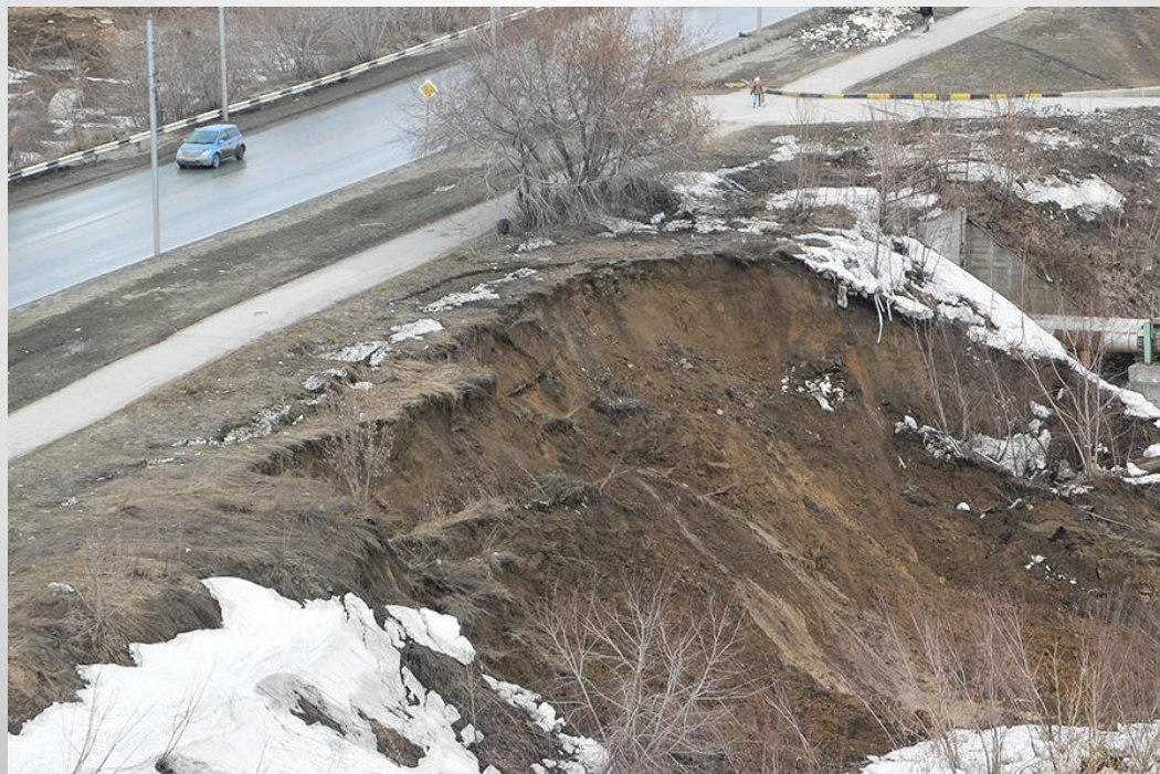
Оползень г. Новосибирск.
