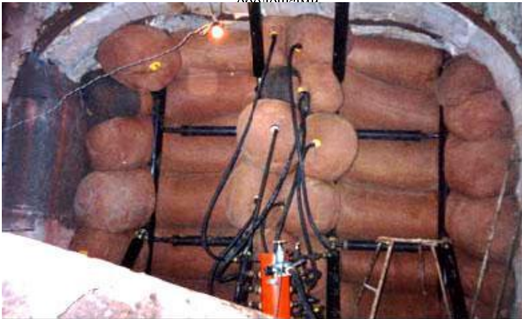
Пневматическая перемычка закаченными сжатым воздухом оболочками
