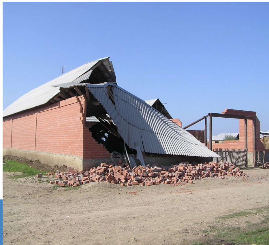
Обрушение стеновых конструкций и кровли здания
