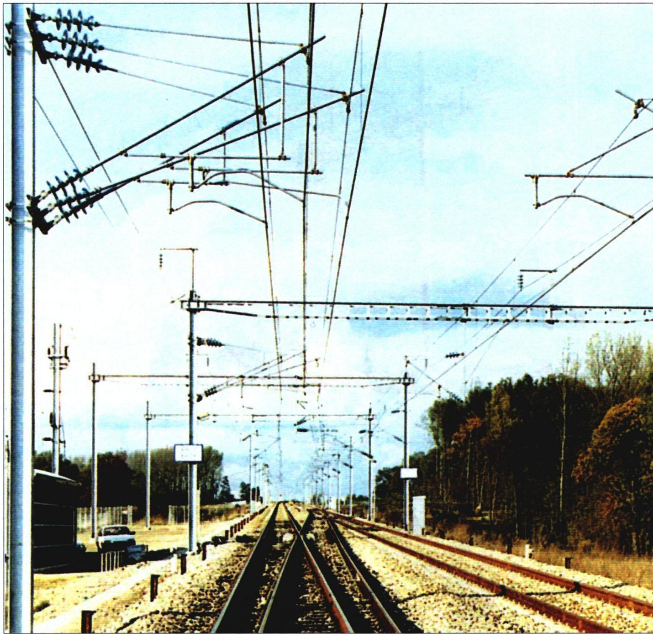
Контактная подвеска на ВСМ с максимальной скоростью движения 300 км/ч в районе воздушной стрелки. Франция. 2000 г.
