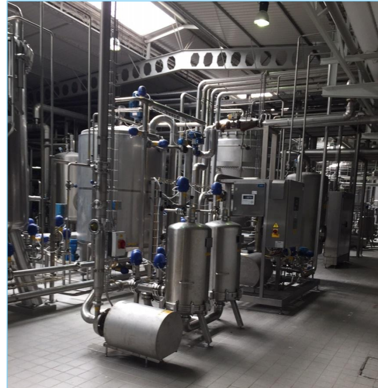
Пример системы регенерируемого PVPP на пивзаводе
