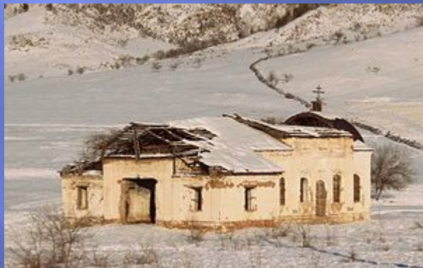
Полуразрушенная Баян-Хосунская церковь
