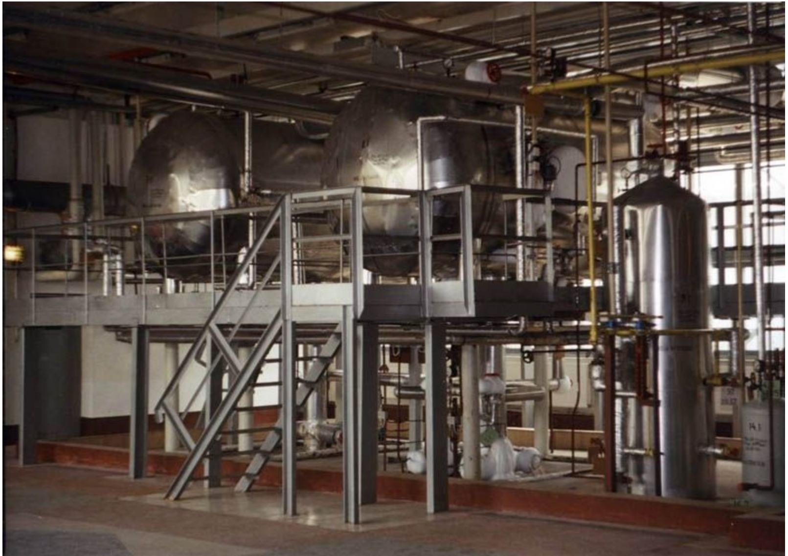
Компрессорная холодильника нового поколения
