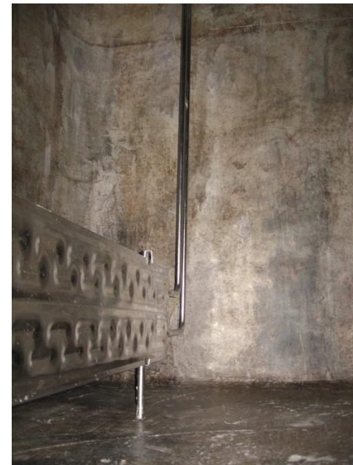
Внутренняя поверхность резервуара с устройством для регулирования температуры
