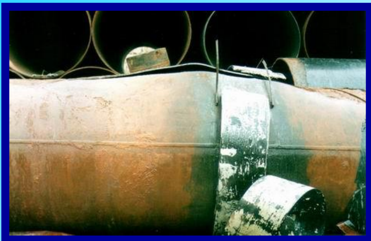
Внешний вид места разрыва трубы и муфты КСЛ
