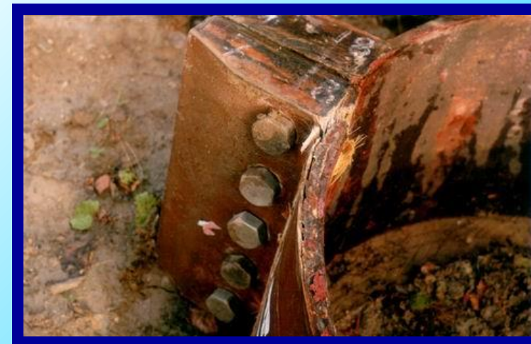
Разрушение стенки муфты ЭСМ в зоне болтового соединения
