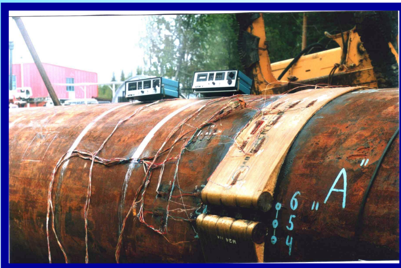
Тензометрическое обустройство муфты РСМ-1220 и прилегающей зоны
