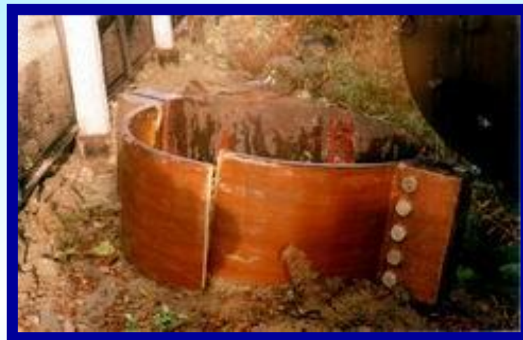
Внешний вид разрушенной муфты ЭСМ
