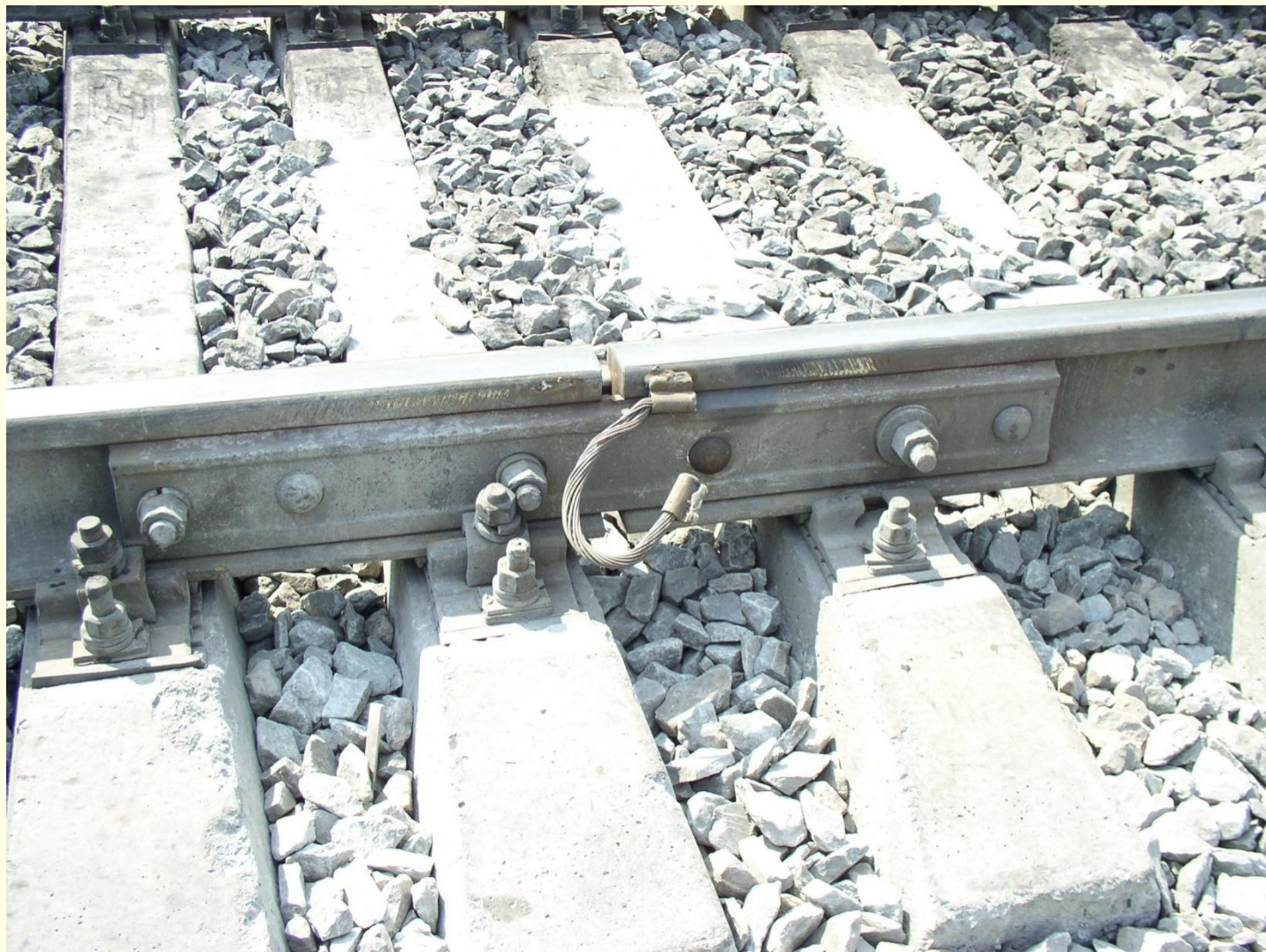
Неисправный стыковой соединитель
