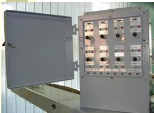
Щиток переездной сигнализации ЩПС-92
