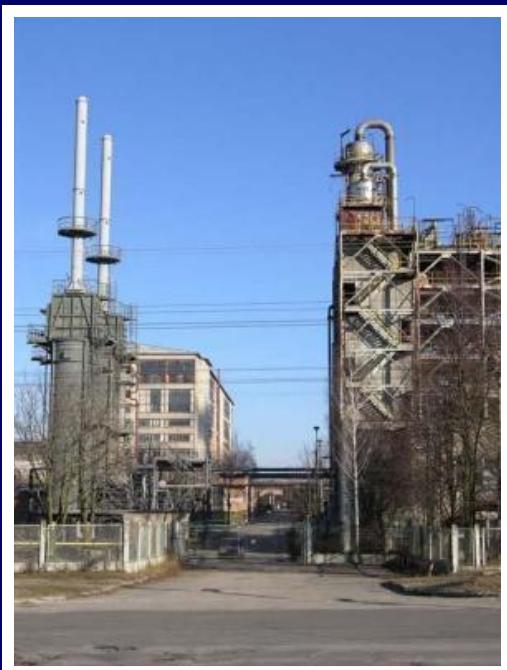
Комплекс по переработке нефти
