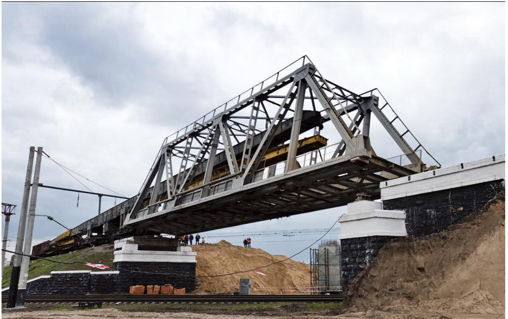
Рабочий момент демонтажа металлического пролетного строения со сквозными фермами с ездой понизу пролетом 33,6 м с помощью консольного крана ГЭПК-130
