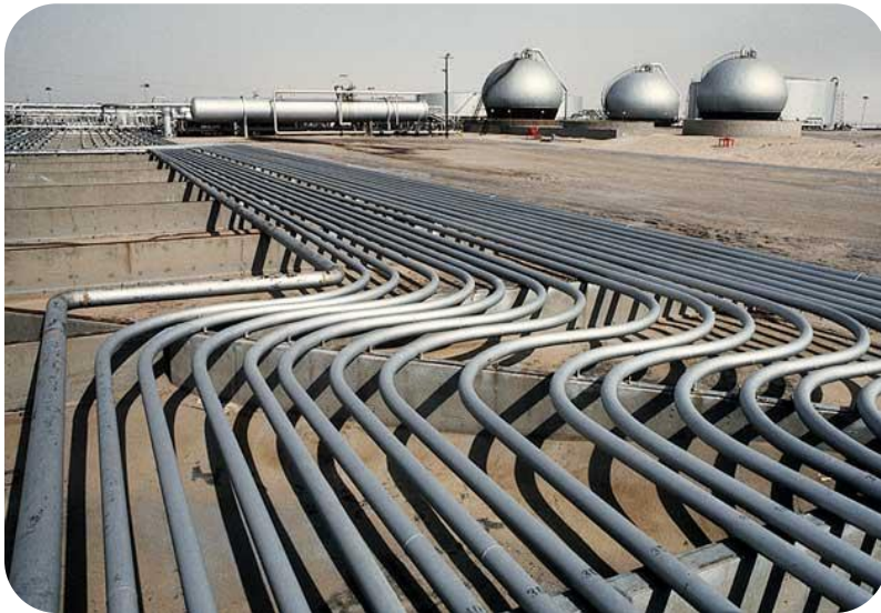
Трубопровод к одному из заводов
