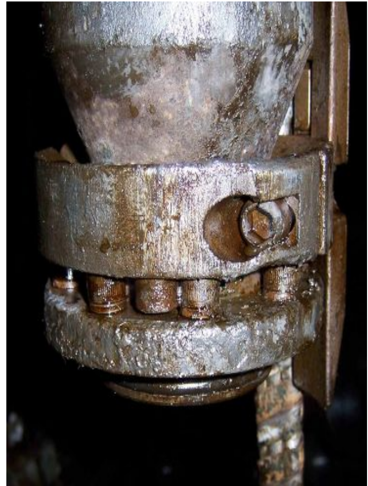
Расчленение УЭЦН по шпилькам.
