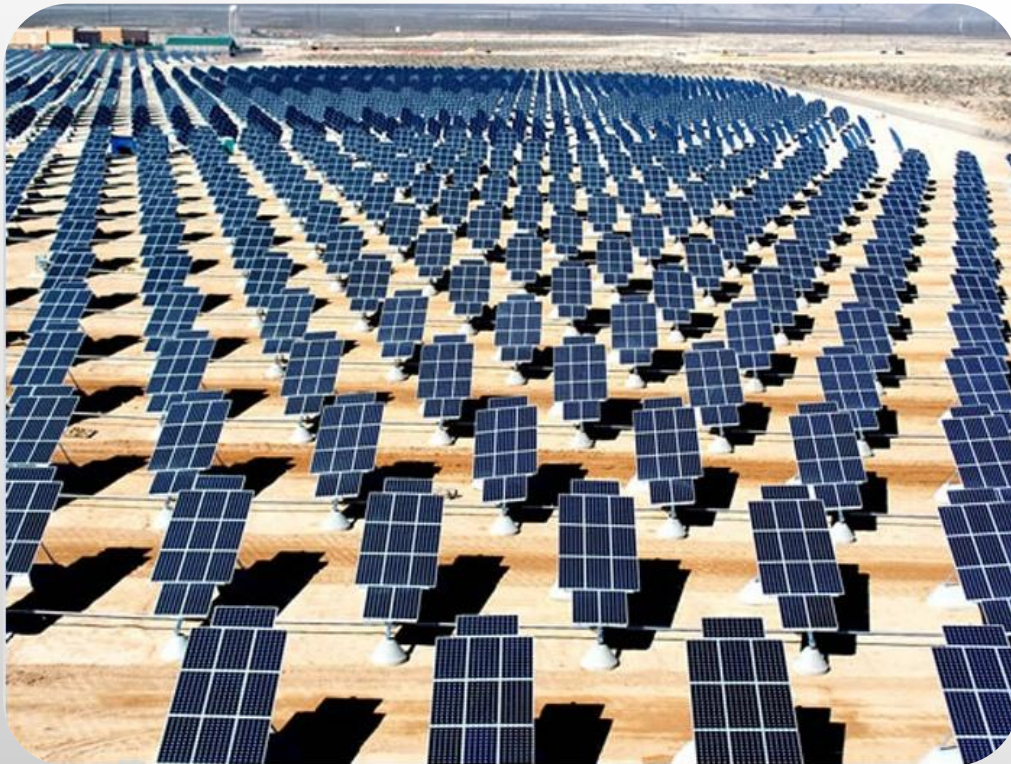
Рис. 1 Сонячна електростанція із одновісною системою слідкування за сонцем.
