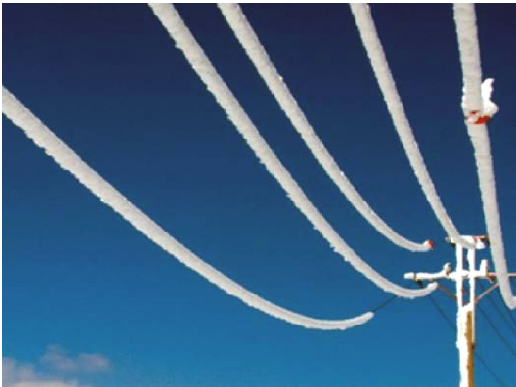
Гололед и снежные образования на проводах ВЛ
