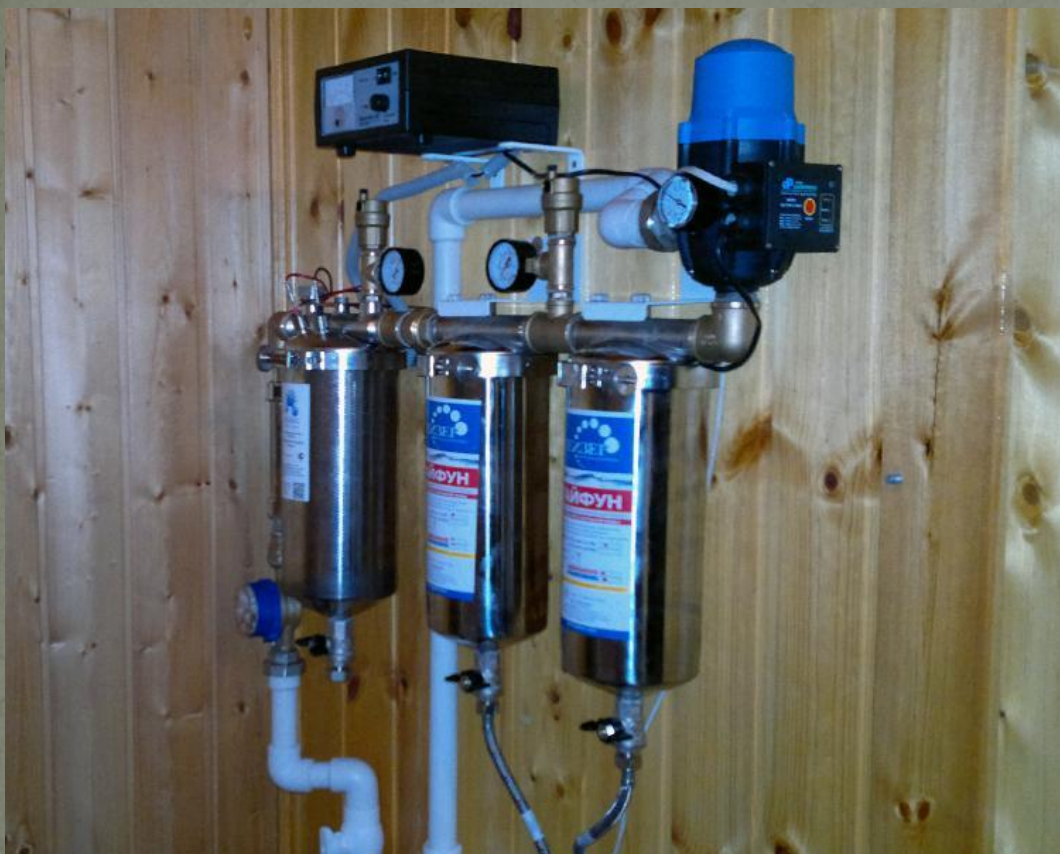
Система водоочистки Дополнительный фильтр
