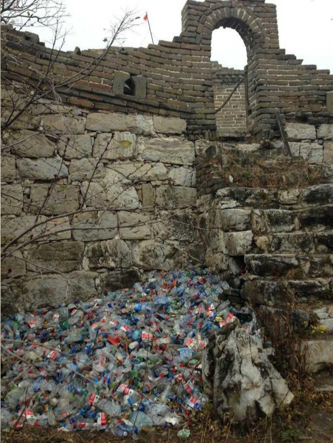
La Grande Muraille de Chine dans un état catastrophique
