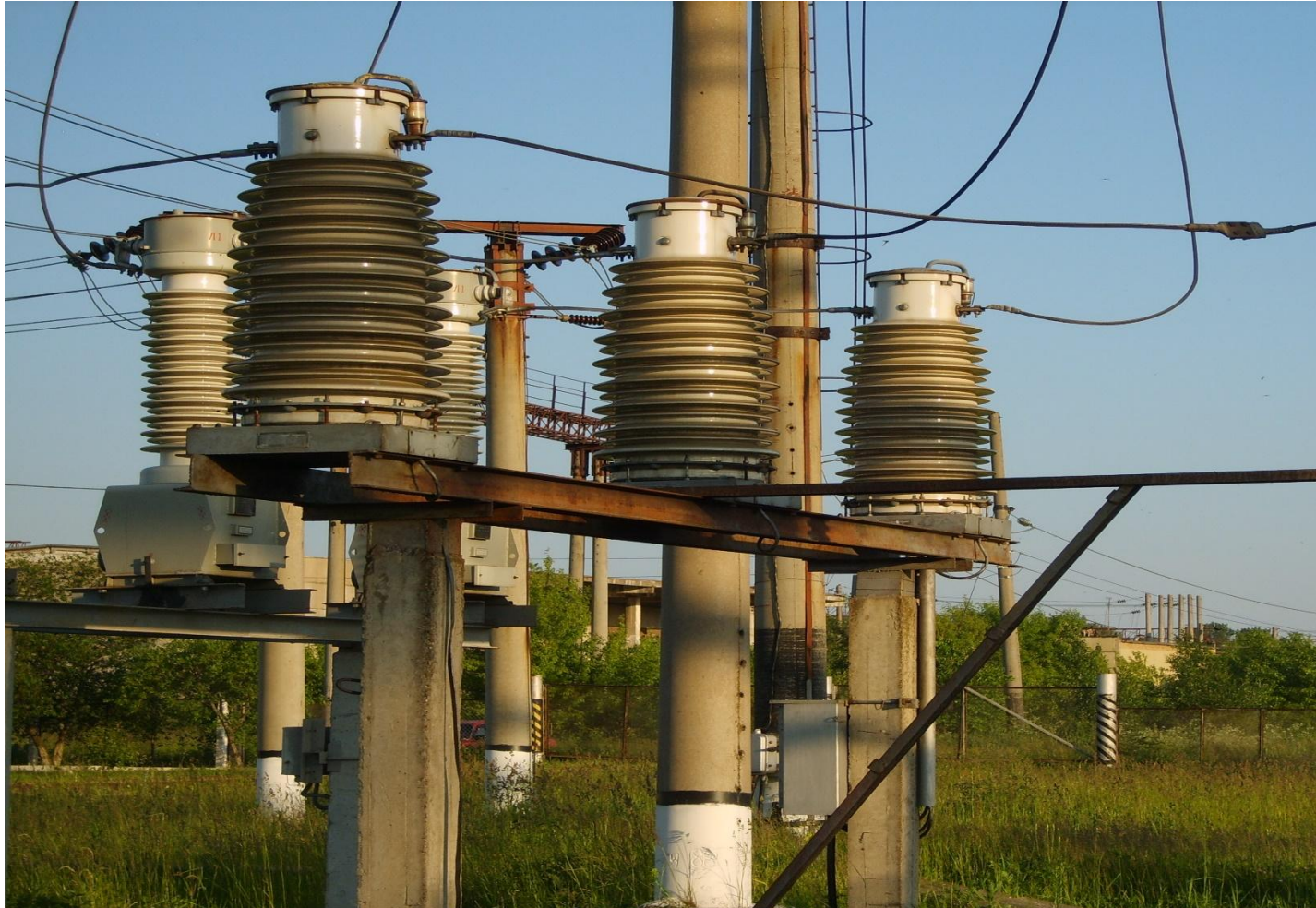
Измерительные трансформаторы тока 110 кВ
