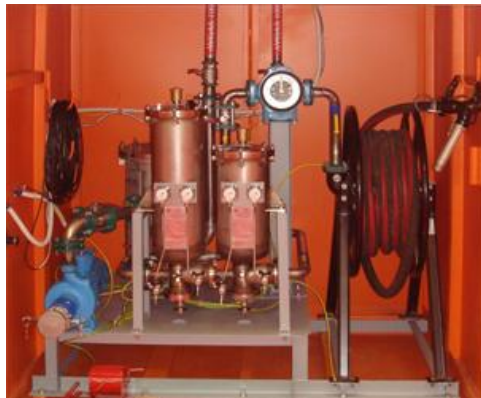
отсек приема и выдачи с оборудованием
