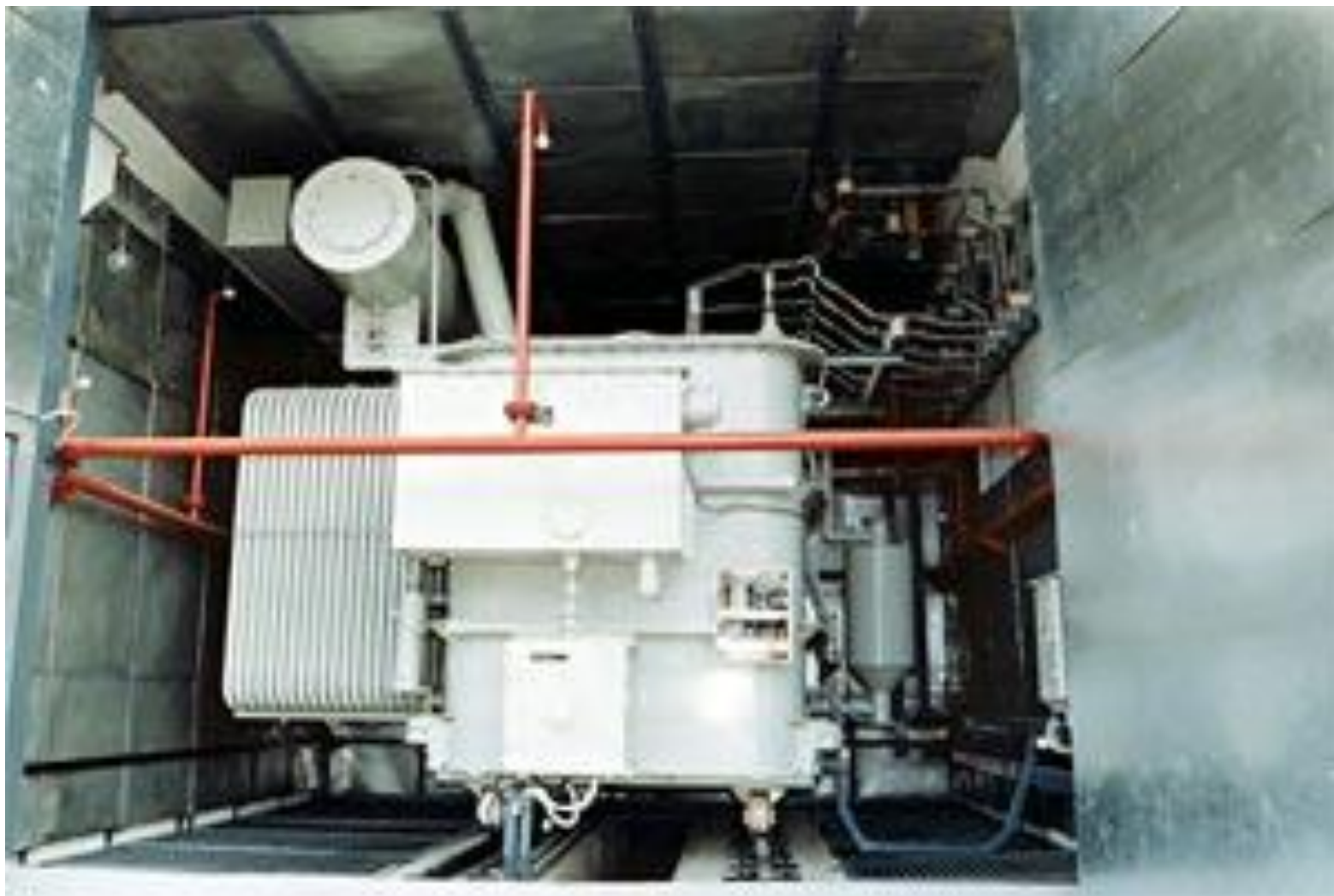
Трансформатор вольтодобавочный ТДНЛ-40000/10
