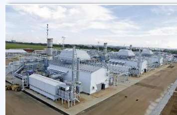
ГТУ-6ПГ в составе дожимных компрессорных агрегатов ООО «ЛУКОЙЛ- Пермнефтеоргсинтез»
