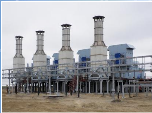
4 ГТЭС «Урал-6000», Пяяхинское МНГ ООО «Лукойл-Западная Сибирь» Наработка: 68 728 часов
