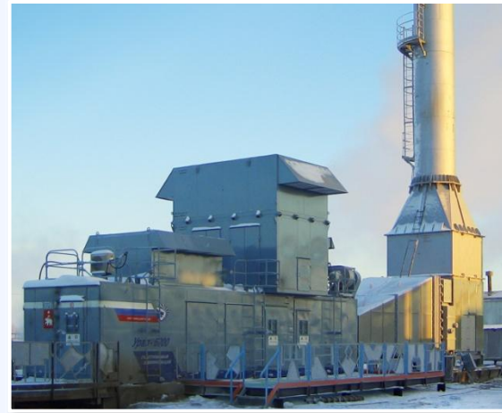
ГТЭС «Урал-6000», Северо-Губкинское МНГ, ООО «ЛУКОЙЛ-Западная Сибирь» Наработка: 63 309 часов
