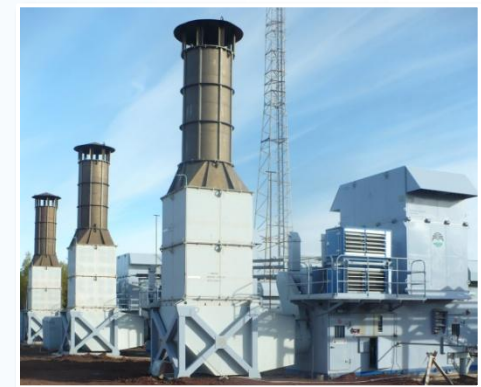
4 ГТЭС «Урал-6000», Ярактинское НГКМ, ООО «Иркутская нефтяная компания», Наработка: 33 893 часа
