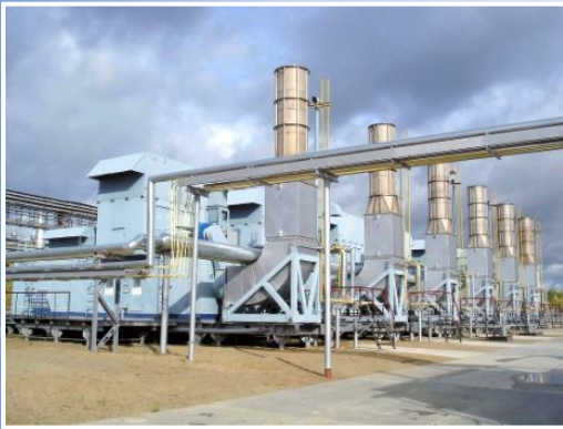
6 ГТЭС «Урал-2500», Сосьвинское ЛПУ ООО «Газпром трансгаз Югорск» Наработка: 160 224 часа
