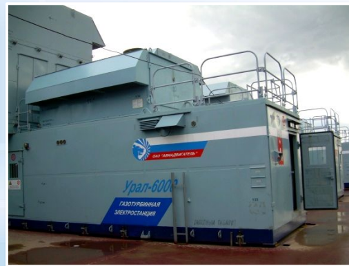
6 ГТЭС «Урал-6000», Бованенковское НГКМ, ООО «Бургаз» Наработка: 46 284 часа
